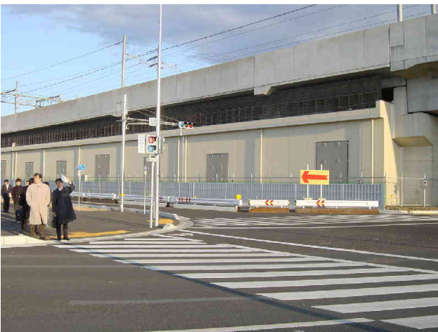
守谷変電所の全景（高架下設置）
