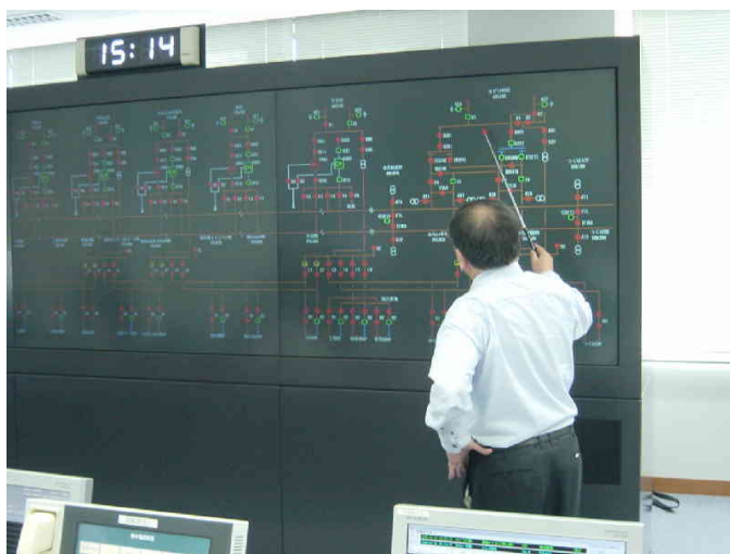
系統監視システム
